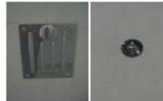
Mecanismos de descarga de agua y de apertura de ducha de presión
