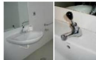
Lavamanos suspendidos con mecanismos de apertura de palanca
