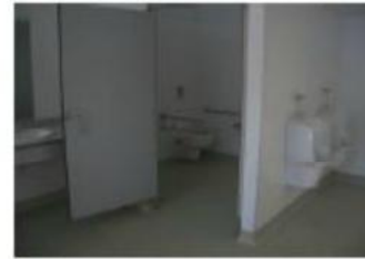
Instalación sanitaria adaptada
